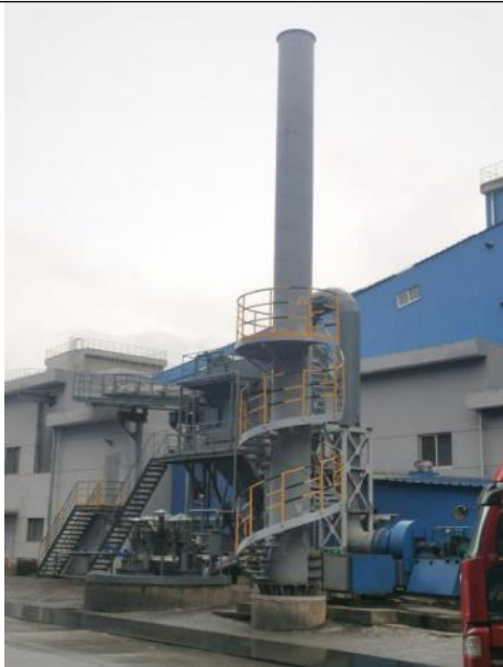
DA046 4#烧结机混合湿式除尘及排气筒
