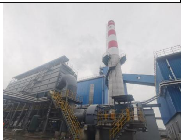
DA044 燃料破碎除尘及烟囱
