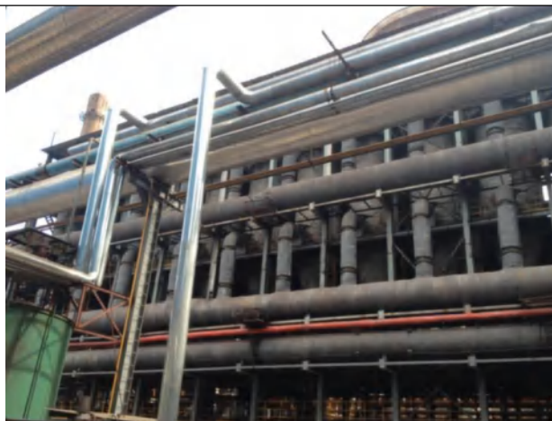
1#、2#高炉煤气重力除尘+干法布袋除尘净化设施
