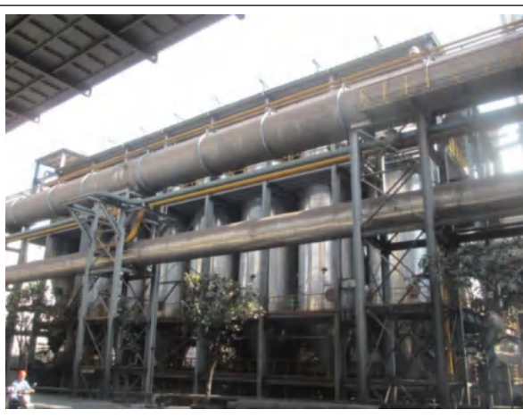
3#高炉煤气重力除尘+干法布袋除尘净化设施
