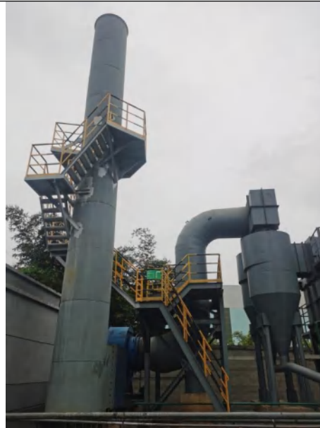
DA039 5#烧结机混合湿式除尘及排气筒
