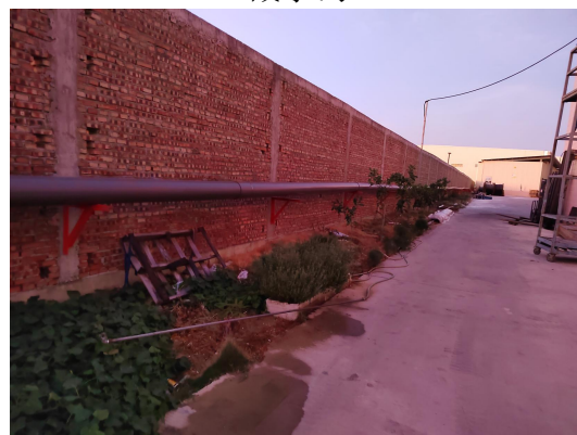
事故废水导流管道
