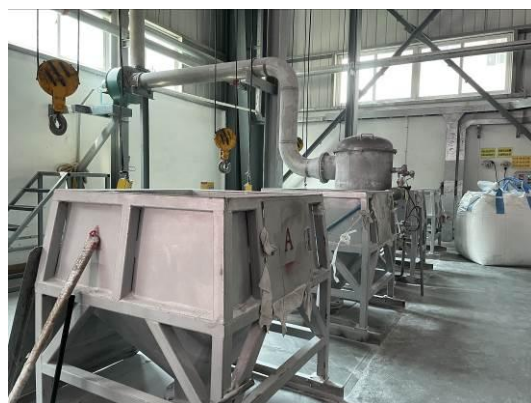
PTA 投料废气滤筒除尘器
