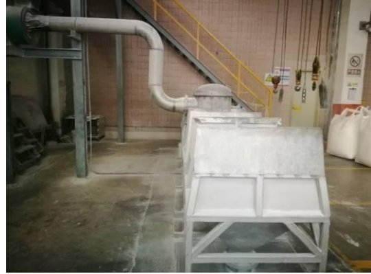
PTA 加料废气密闭及除尘设施
