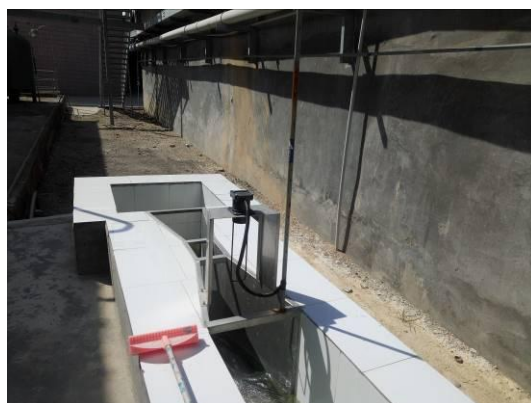
污水处理站出水在线监控设施（依托设施）
