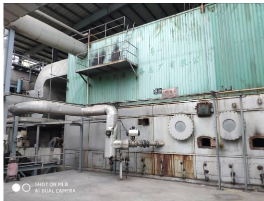
聚酯工艺废气接入锅炉焚烧
