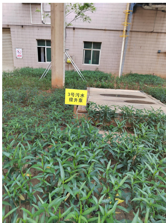
污水提升泵站
