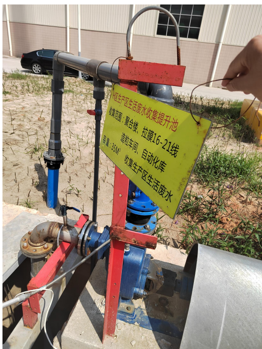
生活污水提升池及提升泵站
