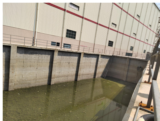
整改后的容积为 8900m 3 的事故废水池
