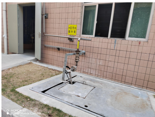
生产废水提升池和提升泵
