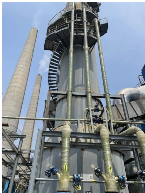
5#热媒站锅炉锅炉废气脱硫设施（石灰石石膏法）
