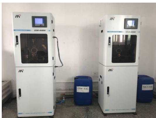
废水 COD、氨氮在线监控设施（依托设施）
