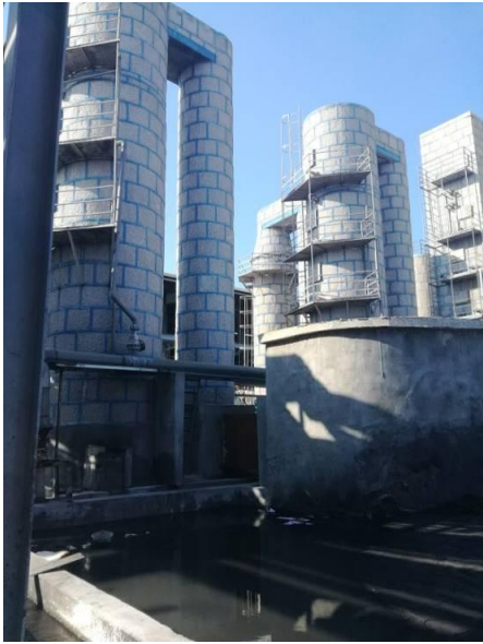
2#热媒站锅炉脱硫除尘设施
