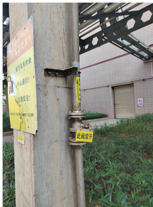
污水输送管道
