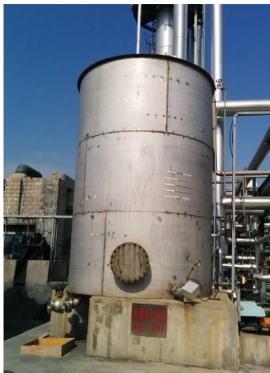
高浓（聚酯）废水储罐及汽提塔
