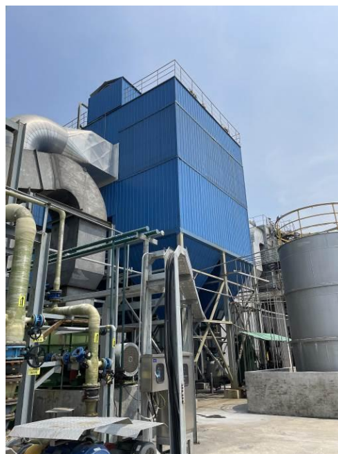
5#热媒站锅炉袋式除尘设施
