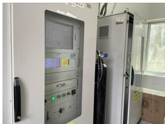
锅炉烟气在线检测设施
