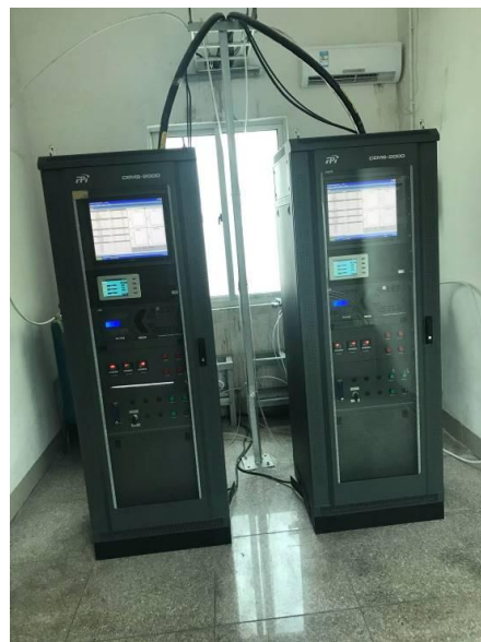
2#热媒站锅炉烟气在线监控系统
