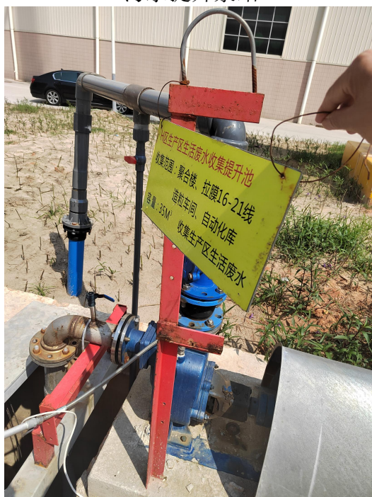
污水提升泵站
